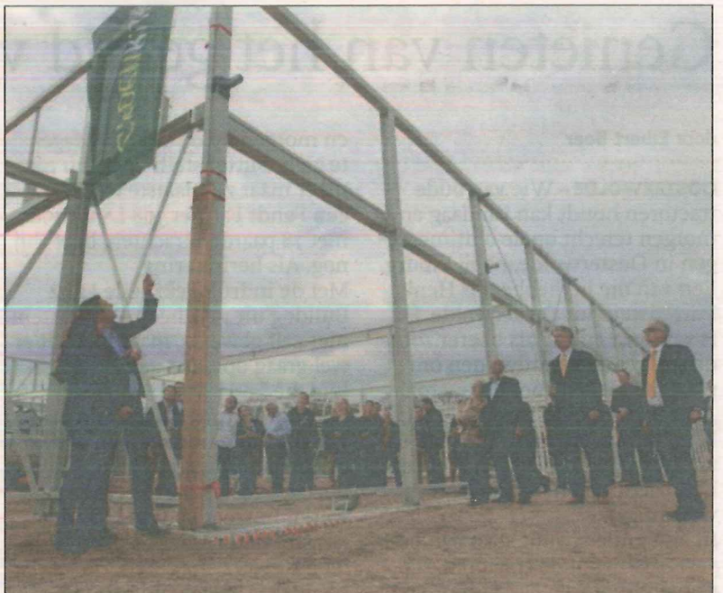
■ Hoogste punt van de bouw van GroenRijk in Epe werd gisteren gevierd. foto Cees Baars
